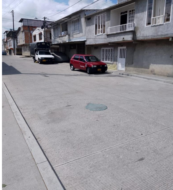
Foto 2. Panorámica de la obra de Pavimentación Barrio Villa Jerusalén Tramo Mz. B. – Fuente: visita técnica C.G.Q.
