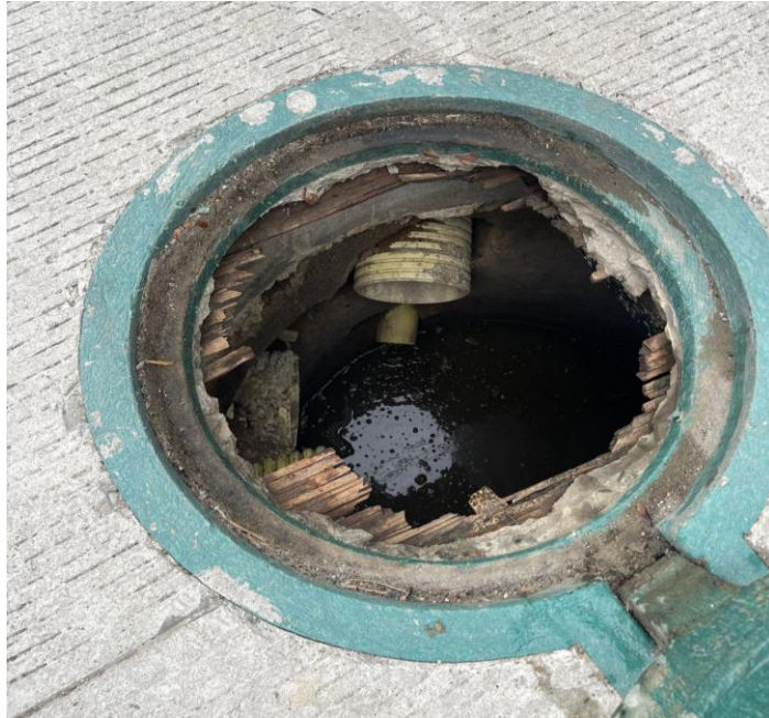
Foto 8. Pozo de Inspección obstruido. – Fuente: Arq. M. Márquez. Líder del Proceso de Alcantarillado E.P.Q.
