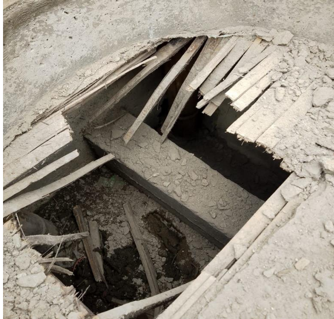
Foto 4. Sumidero con vertedero. Se aprecia que no se ha realizado la limpieza respectiva de la formaleta de realce y los escombros permanecen en el sistema de alcantarillado. – Fuente: visita técnica C.G.Q.
