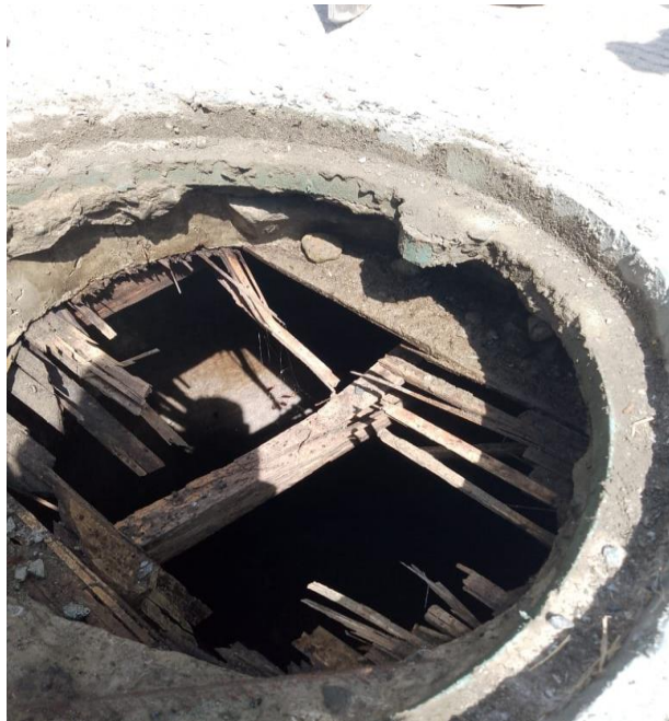
Foto 3. Pozo de inspección intermedio. Se aprecia que no se ha procedido con el desencofrado del realce de la recámara. – Fuente: visita técnica C.G.Q.
