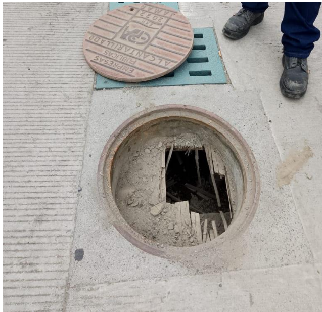
Foto 7. Otra recámara en igual situación, impidiendo las acciones de limpieza y mantenimiento. – Fuente: visita técnica C.G.Q.
