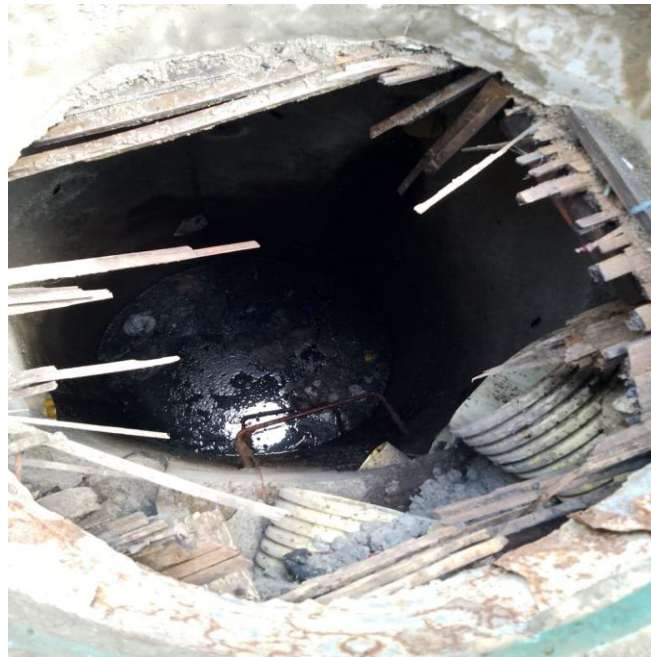
Foto 5. Se aprecia el interior de un pozo de inspección del tramo pavimentado que permanece con escombros y con un alto porcentaje de obstrucción. – Fuente: visita técnica C.G.Q.
