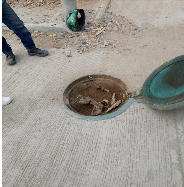
Foto 6. Algunas recámaras no se han desencofrado en lo absoluto, impidiendo las acciones de limpieza y mantenimiento. – Fuente: visita técnica C.G.Q.
