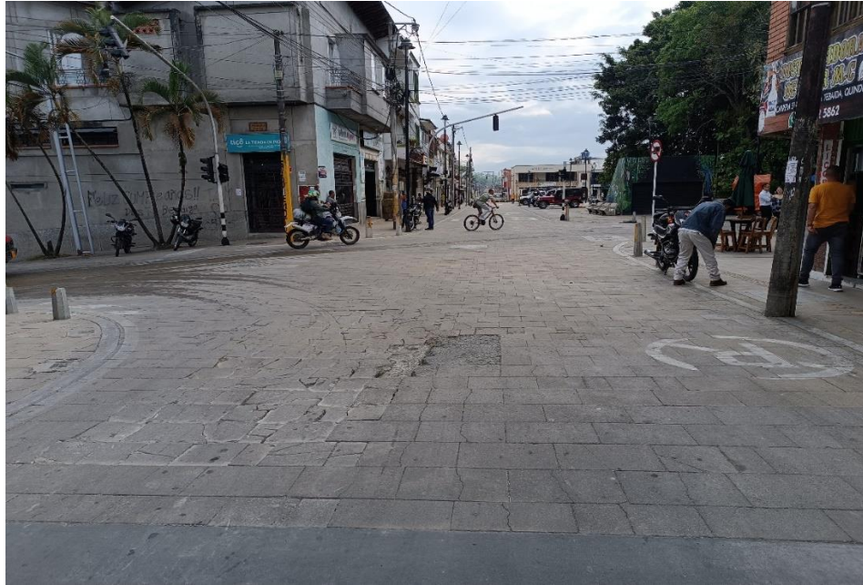
Sector Plaza de Bolívar: falló piso en adoquín
