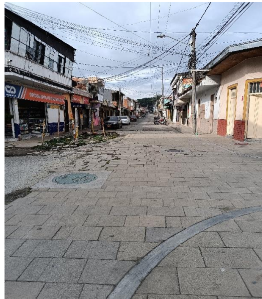
Sector conexiones: adoquín deteriorado
