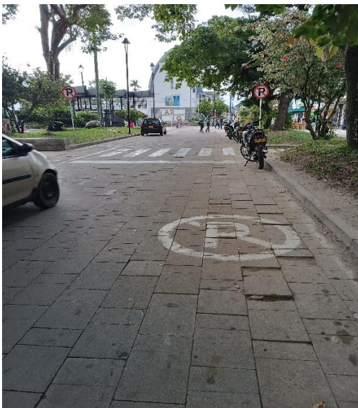
Sector Plaza de Bolívar: adoquín deteriorado
