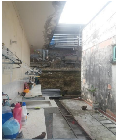
Foto1. Humedades, Centro de Salud de La Virginia Fuente: CGQ, 2019
