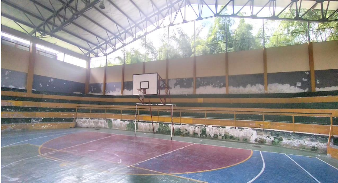
Foto 15. Coliseo Municipal, área interna de muros con pintura deteriorada – Fuente: visita técnica C.G.Q.
