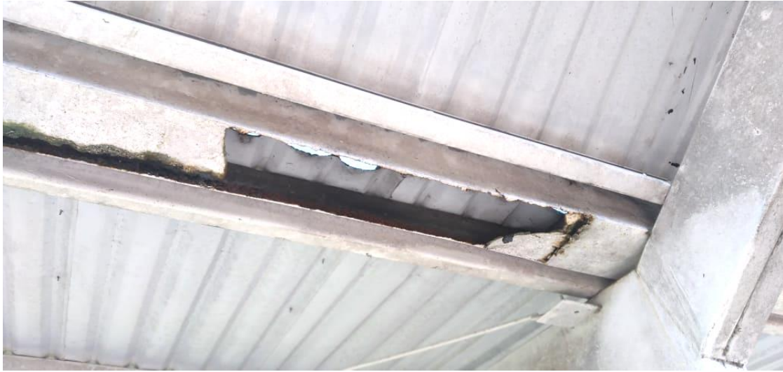
Foto 17. Estadio Municipal, Cubierta de gradería en área sur – oriental. Se presume que por falta de pendiente en la viga, se acumula el agua en este punto y oxida el canal hasta romperlo. – Fuente: visita técnica C.G.Q.
