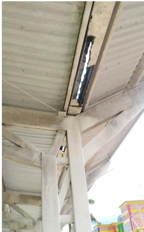
Foto 18. Estadio Municipal, Cubierta de gradería en área sur – oriental. Se observa rotura de viga canal que posteriormente puede afectar la estructura metálica de apoyo de cubierta – Fuente: visita técnica C.G.Q.
