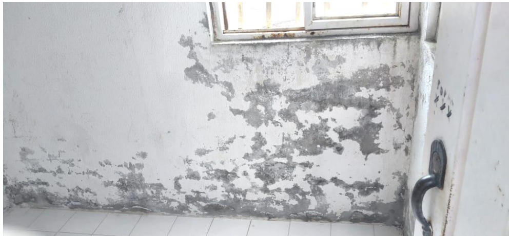
Foto 11. Coliseo Municipal, área de baños con humedades ascendentes por exposición directa del área externa – Fuente: visita técnica C.G.Q.
