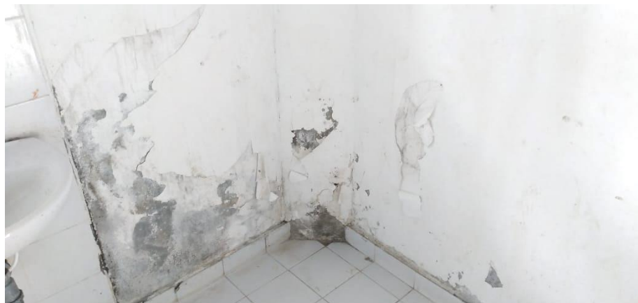
Foto 12. Coliseo Municipal, área de baños con humedades ascendentes por exposición directa del área externa – Fuente: visita técnica C.G.Q.
