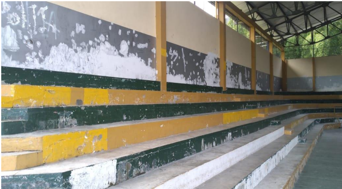
Foto 16. Coliseo Municipal, área interna de muros con pintura deteriorada – Fuente: visita técnica C.G.Q.
